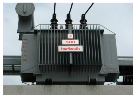
หม้อแปลงไฟฟ้าและตู้ส่งจ่ายไฟฟ้า (ตู้ MDB)
