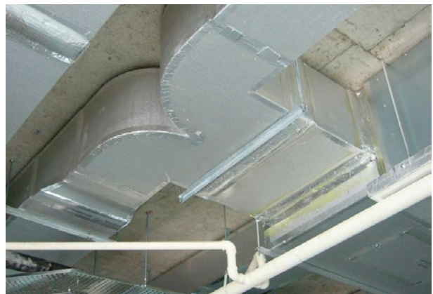
ท่อลม PID (Pre-insulated duct)
