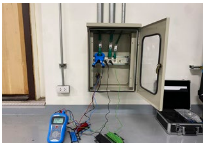
ทดสอบความต้านทานหลักดินของระบบไฟฟ้า
