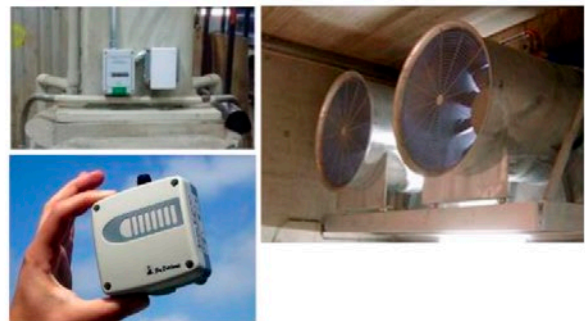
CO SENSOR สำหรับควบคุมรอบพัดลมระบายอากาศในพื้นที่จอดรถ
