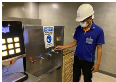
ตรวจสอบการต่อสายดินตู้หน้าตู้
